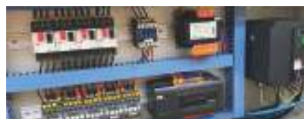
Quadro elettrico con componentistica Schneider
