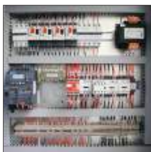
Quadro elettrico chiaro con cablaggi tramite connettori
