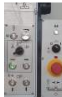
Pannello di controllo semplice ed intuitivo
