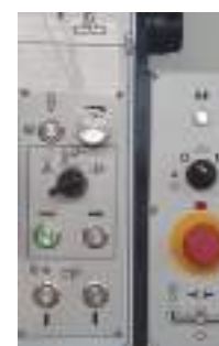
Pannello di controllo semplice ed intuitivo
