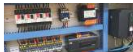
Quadro elettrico con componentistica Schneider
