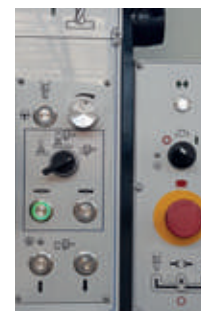
Pannello di controllo semplice ed intuitivo
