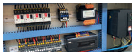
Quadro elettrico con componentistica Schneider
